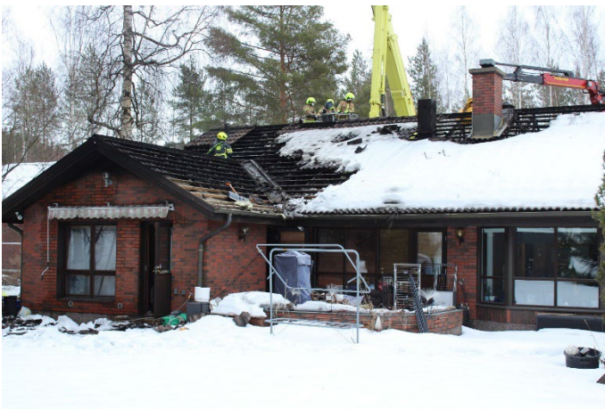
Kuva 18. Lahti, Parsikatu, omakotitalo. Syttymissy eläimen aiheuttama. Jyrsijä (orava?) vahingoittanut sähköjohtoja rakennuksen yläpohjassa aiheuttaen oikosulun/ ylikuumentumista.
